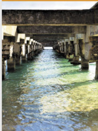
Figura 4.37 Los metales de puentes expuestos a alta humedad ambiental y calor se corroen más rápido.
